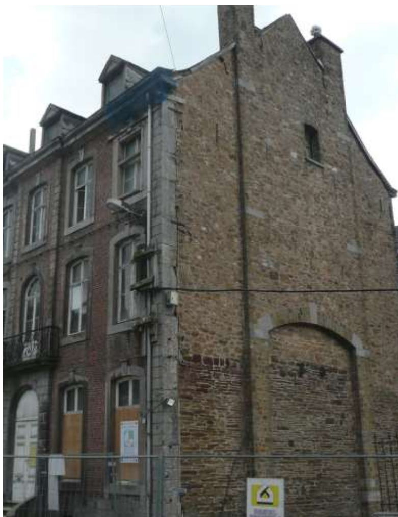
Le pignon de l'Hôtel de Bourbon porte toujours distinctement les traces de l'incendie (Photo J. Toussaint)
