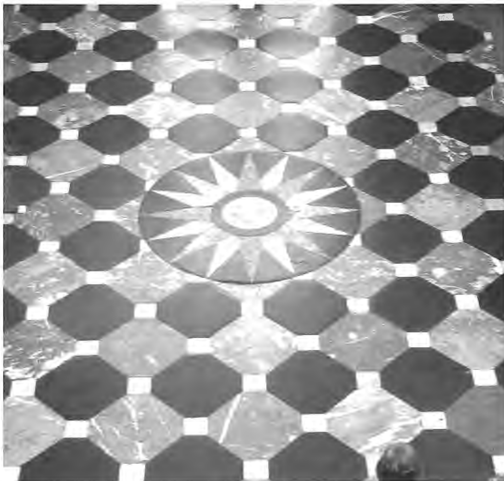
9. La marqueterie de marbre du grand hall d'entrée de « L'escalier royal » tel que conçu par H.F. Hayemal en 1855.
