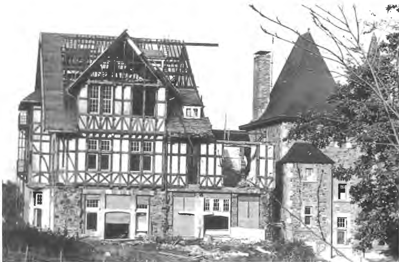
3. Les grands travaux du notaire Emile Labé au château de Fagne Maron : dégagement et rénovation du bâti primitif en concomitance avec le démontage des extensions faites par Gustave Trasenster (photo communiquée par le notaire Labé)
